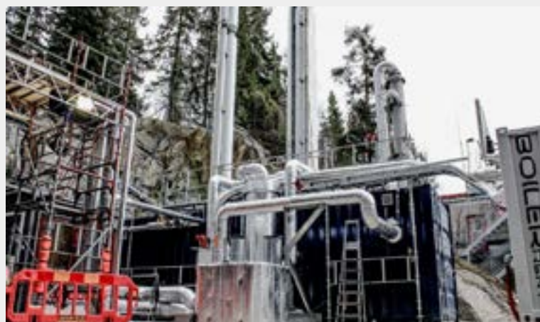
Slik ser piloten av karbonfangstanlegget på Klemetsrud ut. I løpet av 5000 timer med testing, har pilotanlegget fanget over 90 prosent av all CO2-en
